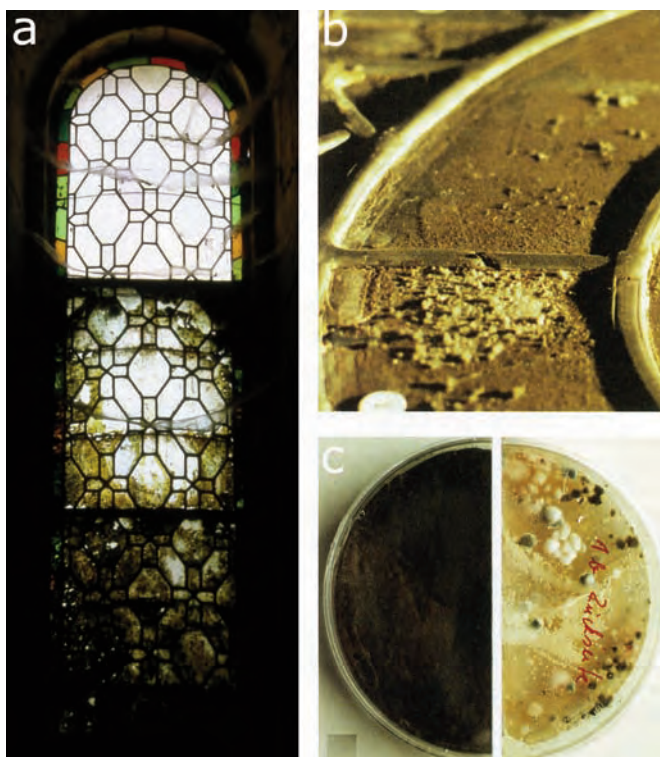
Imagen 5. Biodeterioro de vidrieras. (a) Monasterio de Santes Creus (Tarragona): Vidriera de la nave sur totalmente recubierta por presencia biológica; (b) Abadía de Altenberg (Alemania): panel de vidriera donde se aprecia la formación de una colonia de hongos; (c) Abadía de Altenberg (Alemania): cultivo de las muestras de hongos y microflora extraídas de la cara interior (izquierda) y exterior (derecha) de la vidriera.
