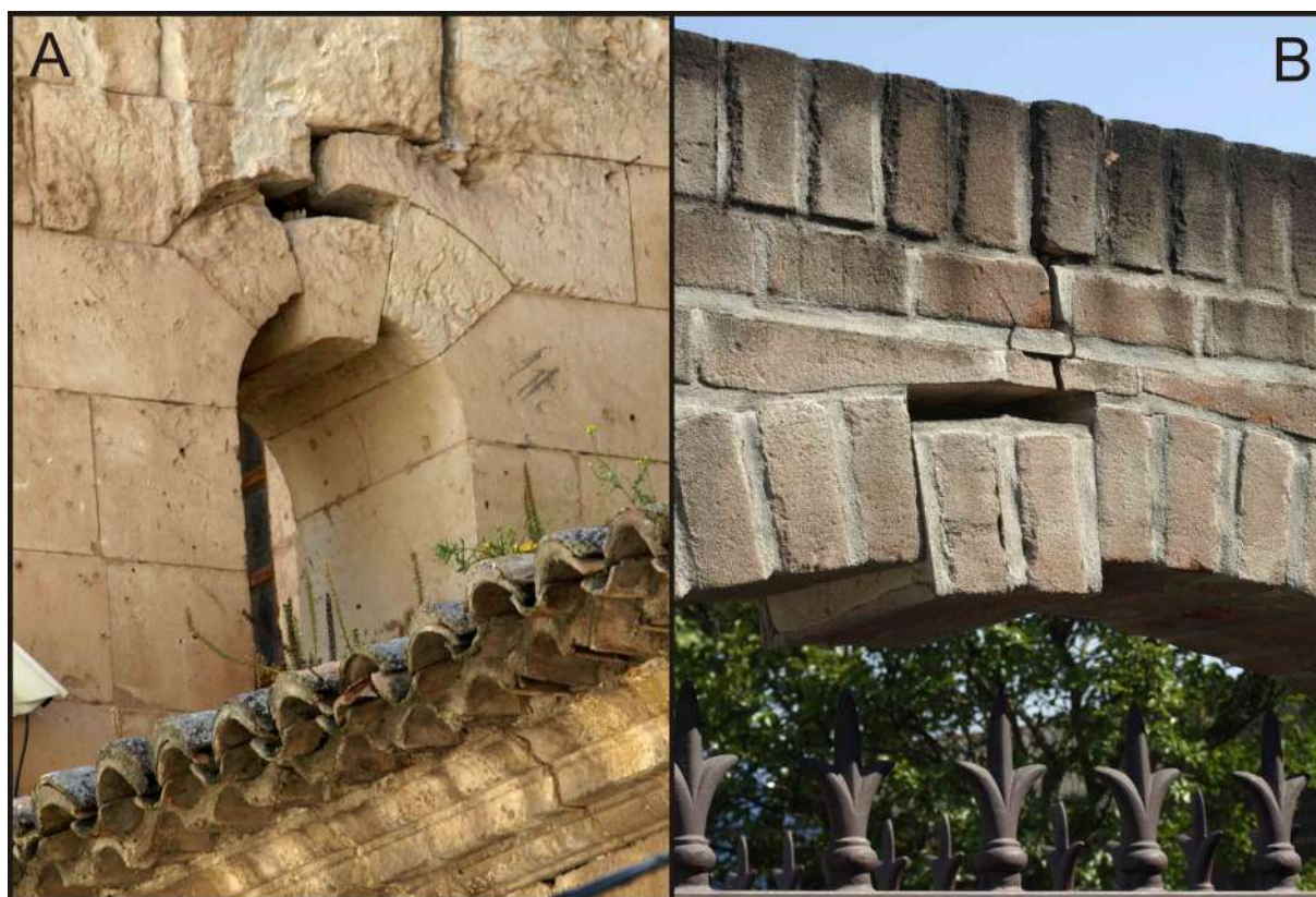
Figura 9. Caída de claves de arco: A) en arcos de sillería de la colegiata de San Patricio Lorca (terremoto del 11 de mayo de 2011); B) en arcos de ladrillo en una casa de la Emilia Romagna (Italia) (terremoto del 20 de mayo de 2012).
