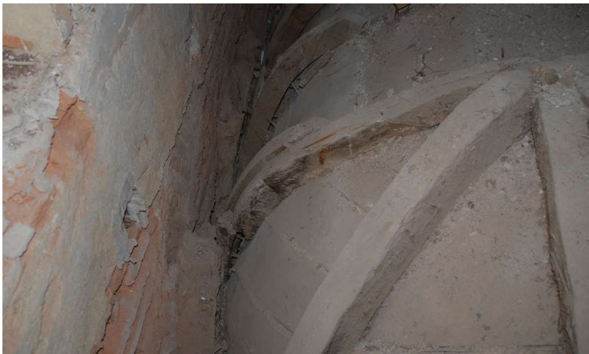
Figura 1. Vista del reverso de una de las bóvedas, donde se aprecian zonas con pudrición. Fotografía: Víctor M. Menguiano.
