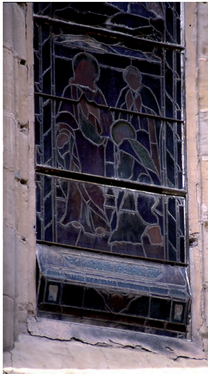
Fig. 15. Detalle de la parte inferior de una vidriera plegada debido a un mal emplomado en la Catedral de Logroño (Foto: Fernando Cortés).
