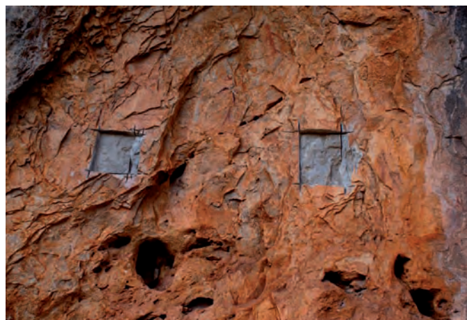
Figura 24. Destrucción de pinturas levantinas en el Abric I de Benirrama (Alicante).
