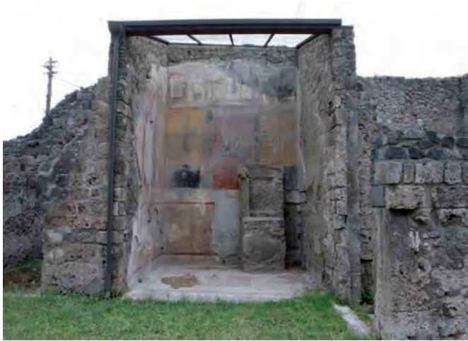
Figura 4. Casa de Ariadna, se observa el Larario 7. Este departamento presenta un sistema de cubierta en policarbonato transparente para la protección de las superficies decoradas.
