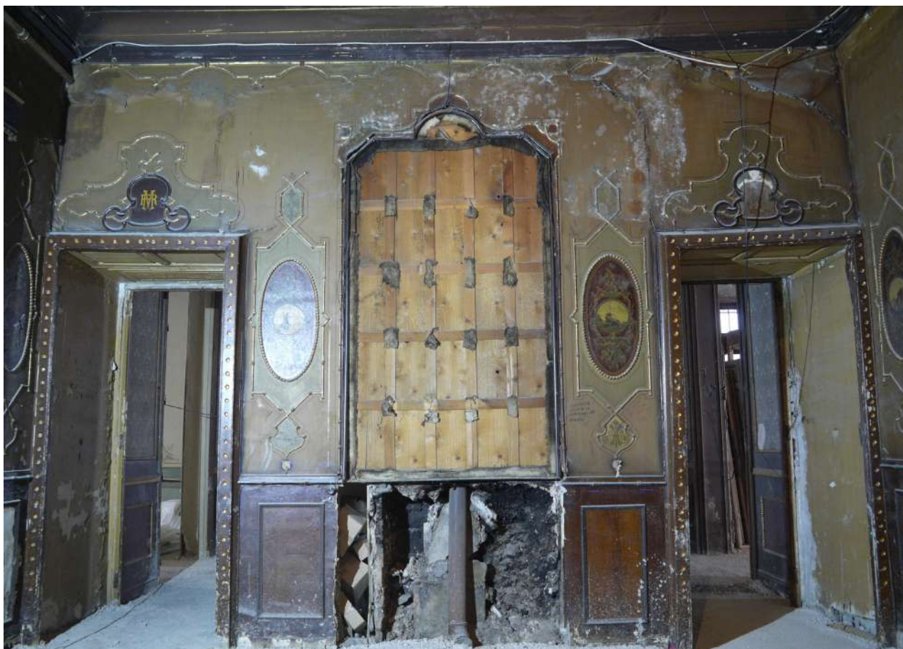
Figura 13. Aspecto de la sala 07 al comenzar los trabajos de rehabilitación del edificio. Fotografía: Elsa Soria Hernanz y Rosa Plaza Santiago.
