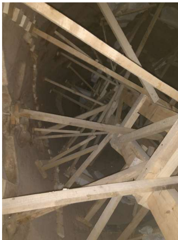
Figura 6. Vista interior de un ninot de remate de falla elaborado con cartón: estructura de madera central, brazos que sujetan la figura y tacos de madera a lo largo de las juntas para la unión de las partes que lo forman.
