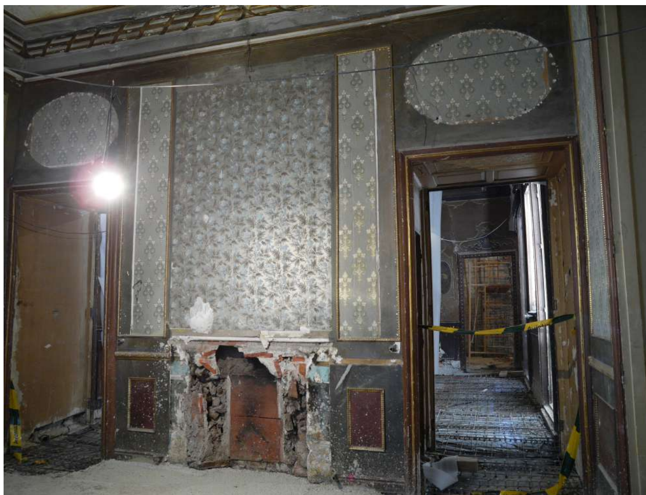
Figura 11. Aspecto de la sala 06 durante el desarrollo de la campaña de trabajo de la ESCRBC. Se pueden apreciar los restos de los papeles pintados de las últimas fases decorativas: los panelados, que estarían cubiertos con tejidos parietales, el papel pintado de fondo verde, y el anterior de inspiración oriental. Fotografía: Elsa M. a Soria Hernanz y Rosa Plaza Santiago.
